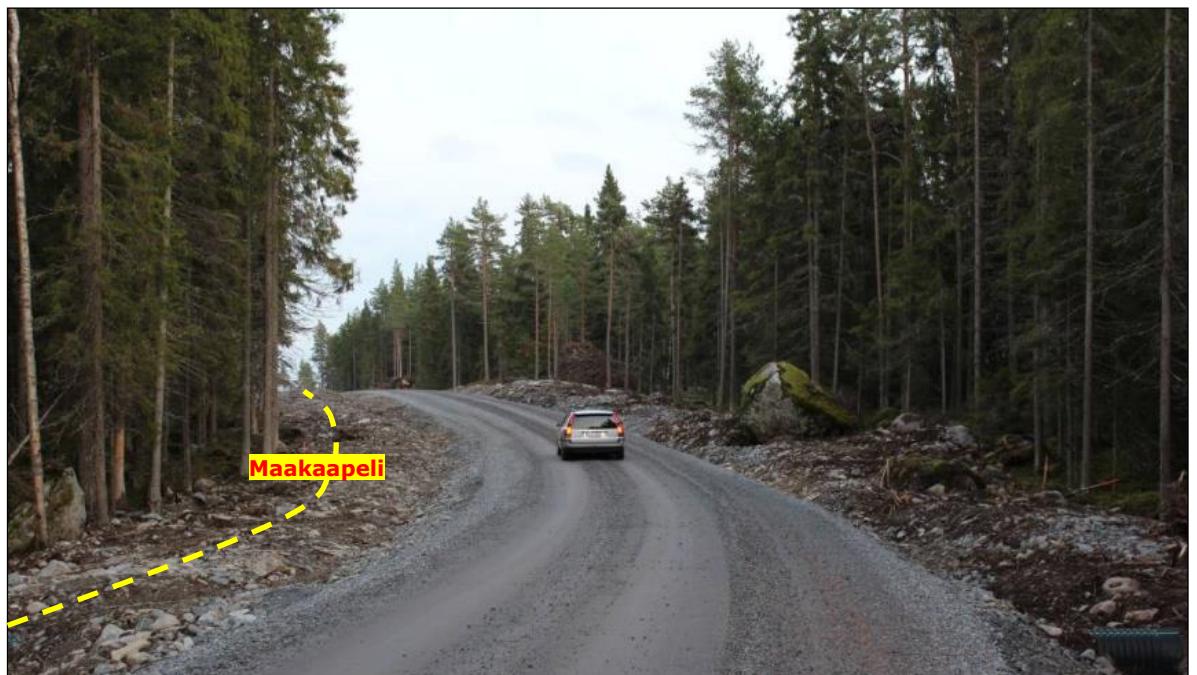
Kuva 10 Esimerkki tuulivoimapuiston rakennus- ja huoltotiestä. Teitä käytetään muun muassa betonin ja soran sekä voimaloiden komponenttien kuljetuksiin. Tuulivoimapuiston käyttövaiheessa teitä käytetään mm. vuosittaisissa huolloissa. Maakaapelin oja on sijoitettu tien vasemmalle puolelle.
